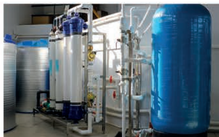
Sistemas de filtración de agua
