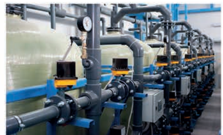
Tratamiento del agua
